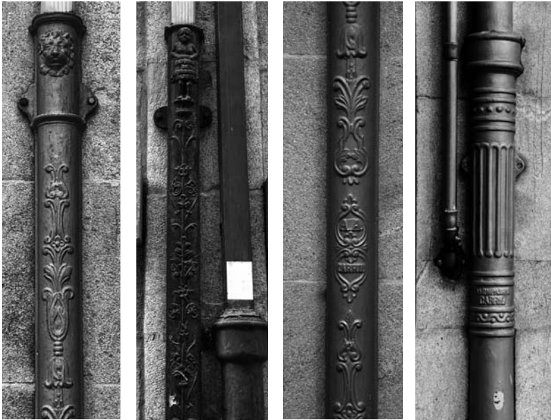
Exemplos de baixantes fundidas no Carril.
